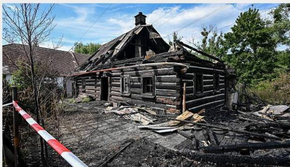
Shořela roubenka, 14. července 2025, Ostrava -Radvanice. | Video: Deník/Lukáš Kaboň
